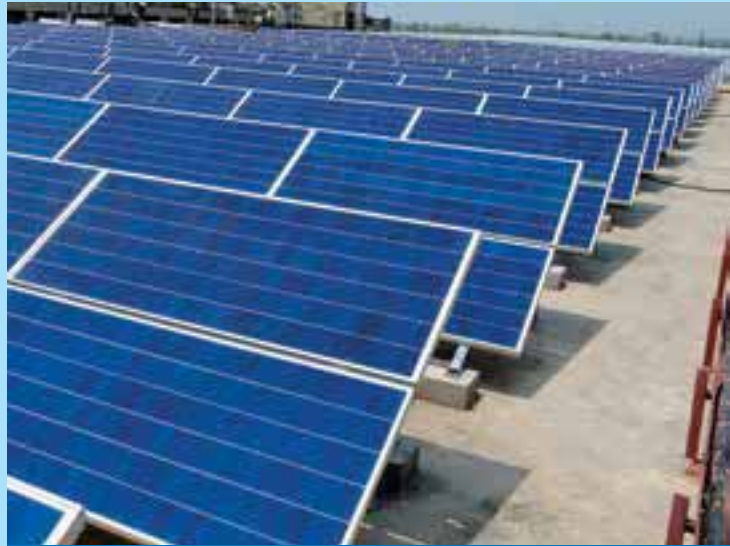
Solar Panels - 291KW
